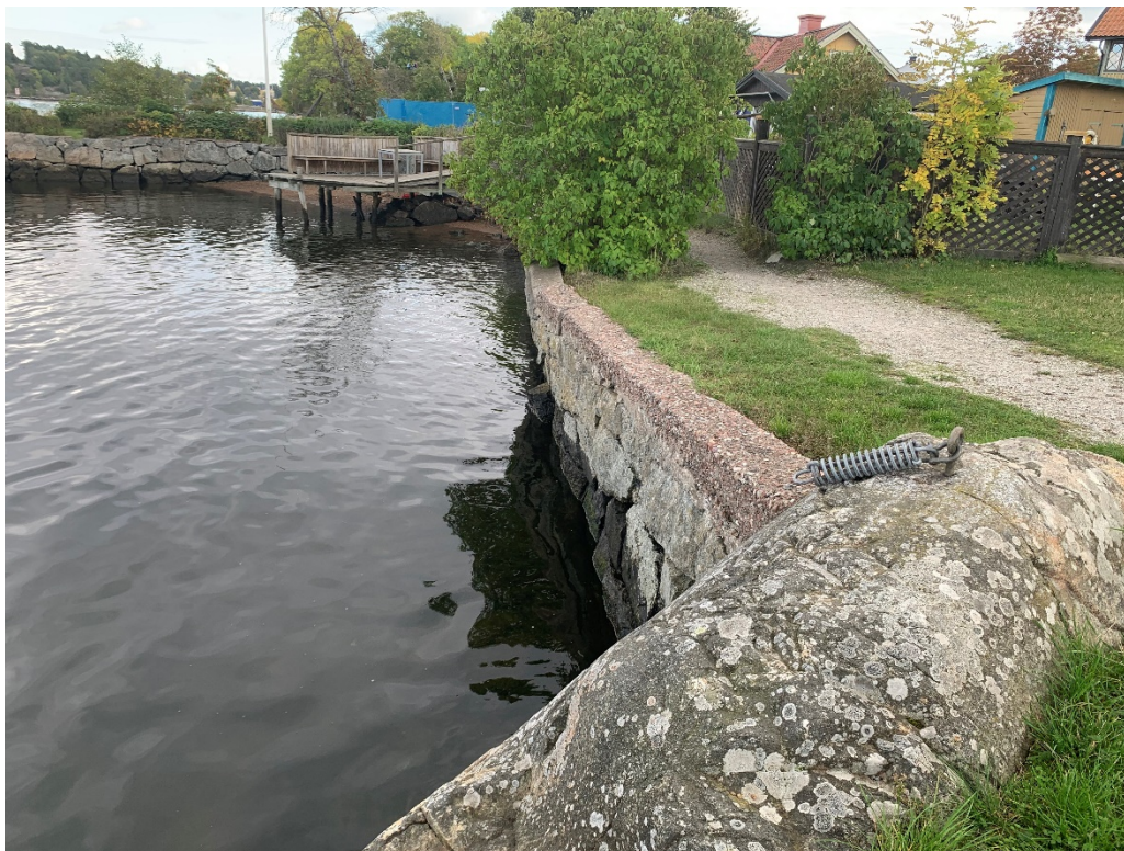
Figur 2 - Exempel på kaj som håller på att rasa bakom hembygdsgården. Den har ett renoveringsbehov till en kostnad som kanske inte är motiverad med hänsyn till att den håller upp en stig som inte är belyst eller vinterväghålls.
