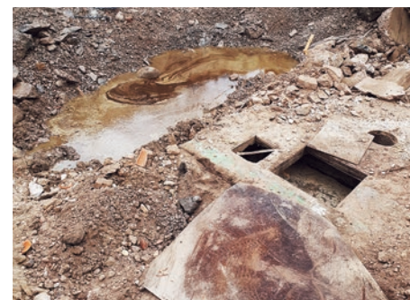
Under ett betonggolvet i Norrbergsskolan hade flera års oljespill samlats. Området är nu sanerat
