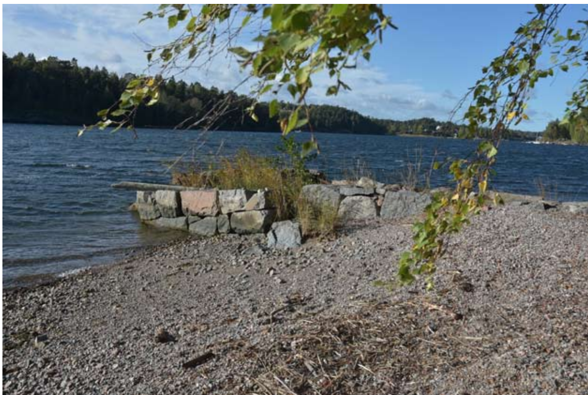
En äldre troligen ursprunglig brygga vid strandlinjen. Bryggan är utförd i tuktade stenkvadrar. Den bör bevaras och murkistan bör läggas om på ny rustbädd av trä.
